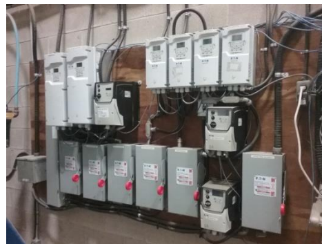
Панель VFDs моторов
